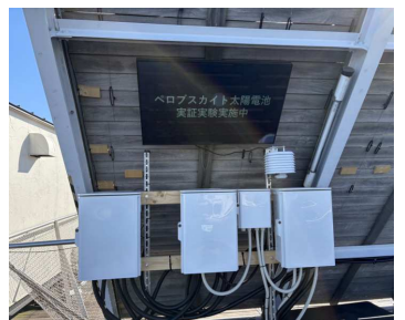
傾斜面裏には蓄電ボックスが
